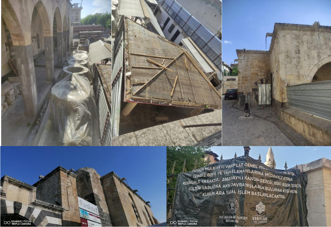
Şekil 2. 6 Şubat 2023 Kahramanmaraş Depremi Sonrası Tahtani Cami Durumu
