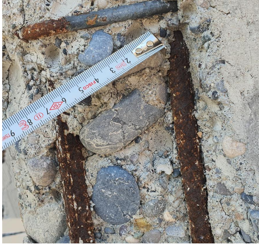
Şekil 8. Betonda uygun olmayan gradasyon
