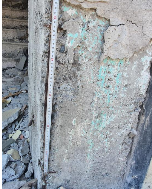
Şekil 10. Betonda uygun olmayan gradasyon
