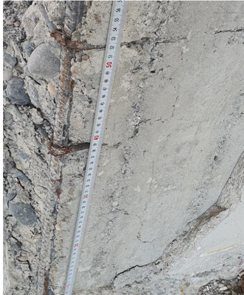
Şekil 6. Betonda uygun olmayan gradasyon
