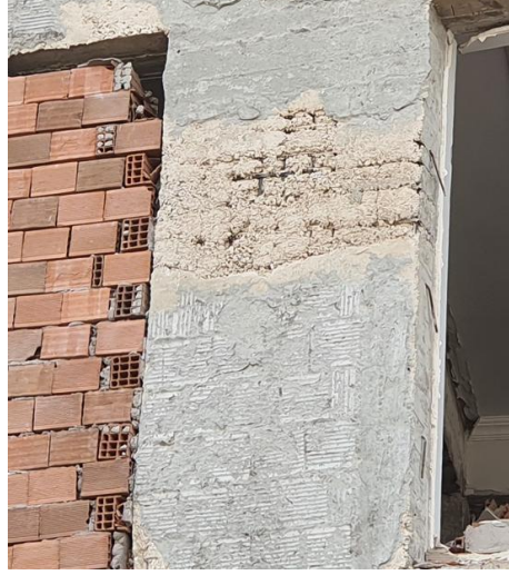
Şekil 5. Segregasyon göstermiş beton
