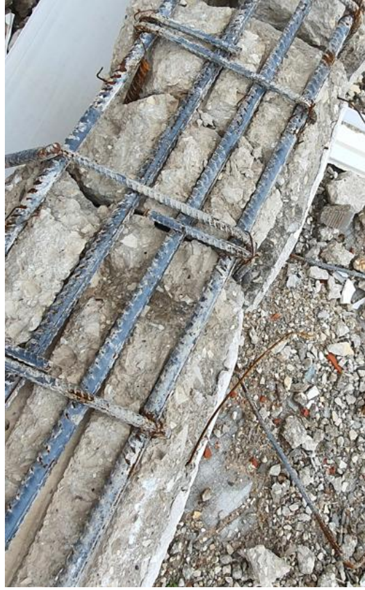
Şekil 11. Betonda uygun olmayan gradasyon
