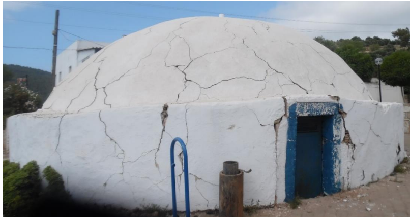
Şekil 2: Depremden Sonra Ağır Hasar Alan Sarnıç (Bodrum Belediyesi-Koruma, Uygulama ve Denetim Bürosu, 2017)
