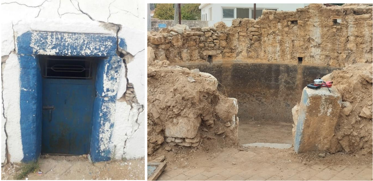
Şekil 12-13: Depremden Önce ve Sonra Dikdörtgen Formlu Giriş Açıklığı (Bodrum Belediyesi-Koruma Uygulama ve Denetim Bürosu 2017/Yıldız, 2025)
