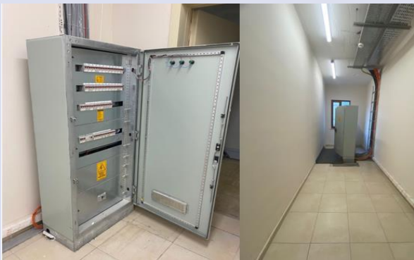
Şekil 11. Elektrik panoları Figure 11. Electrical panels
