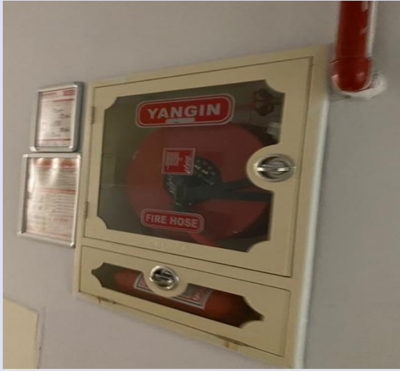
Şekil 2. Yangın tüpü ve hortumu Figure 2. Fire extinguisher and hose
