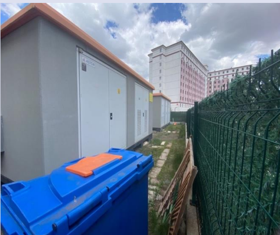
Şekil 4. Jeneratör alanı Figure 4. Generator area
