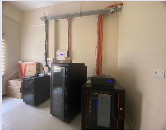
Şekil 3. İdari bina sistem odası Figure 3. Administrative building system room
