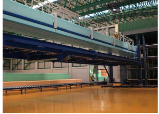
Şekil 5: Soğutma alanında köpük raf sistemleri (Anonim, 2025g).
